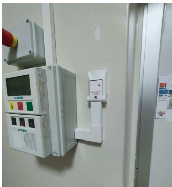
Immagine 2 Pulsante installato presso l'Osservazione Temporanea (risponde alle esigenze di chiamata del lato Emergenze)
